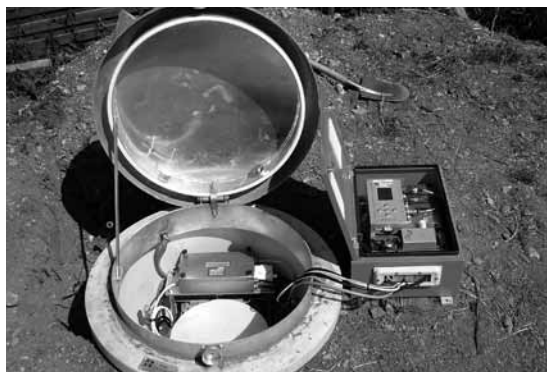
Abbildung 2: Das neue Installationssystem «broadband accelerometer» für die Messung der Starkbeben in der Schweiz; Quelle: SED/ETHZ
